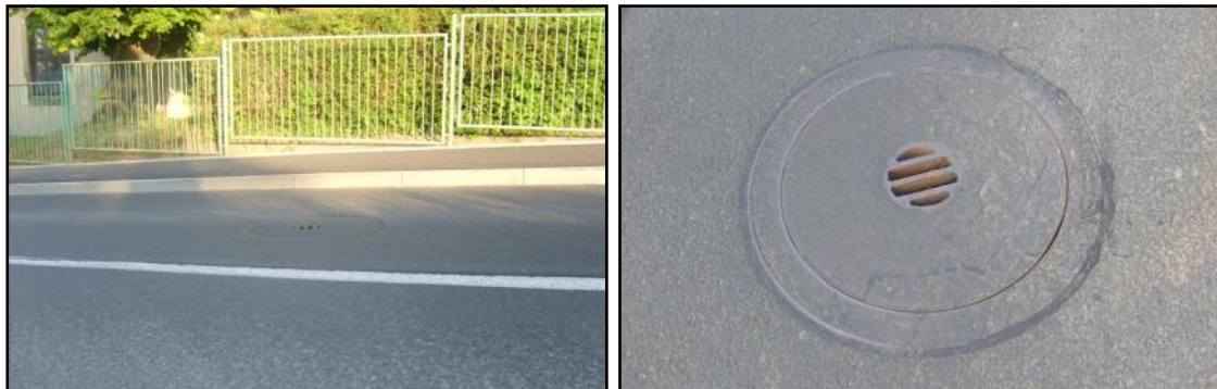
Abb. 19 Lärmarme Schachteindeckung (Beispiel Dresden)
