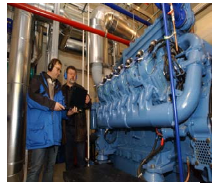
Blockheizkraftwerk Gorndorf Quelle: Stadtwerke Saalfeld GmbH
