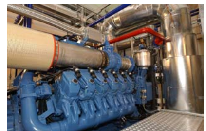
Blockheizkraftwerk Gorndorf Quelle: Stadtwerke Saalfeld GmbH
