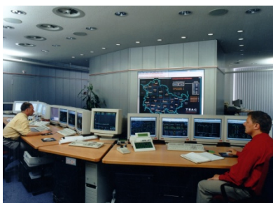
Netzeitzentrale E.ON Thüringer Energie AG
