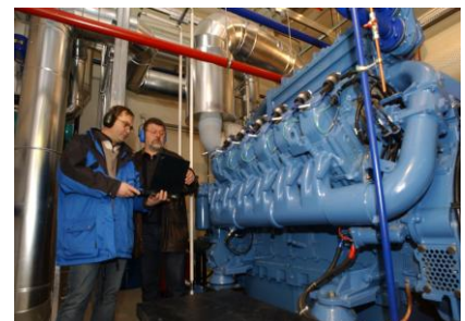
Blockheizkraftwerk Gorndorf Quelle: Stadtwerke Saalfeld GmbH
