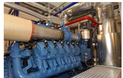
BHKW Gorndorf Quelle: Stadtwerke Saalfeld GmbH
