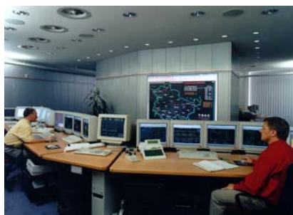
Netzeitzentrale Erfurt Quelle: E.ON Thüringer Energie AG
