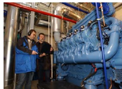
Blockheizkraftwerk Gorndorf Quelle: Stadtwerke Saalfeld GmbH
